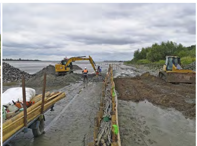
Abb. 7: Die Kleiberme wird durch ingenieur-biologische Bauweisen vor Erosion geschützt. (Foto: WSA Elbe-Nordsee)
